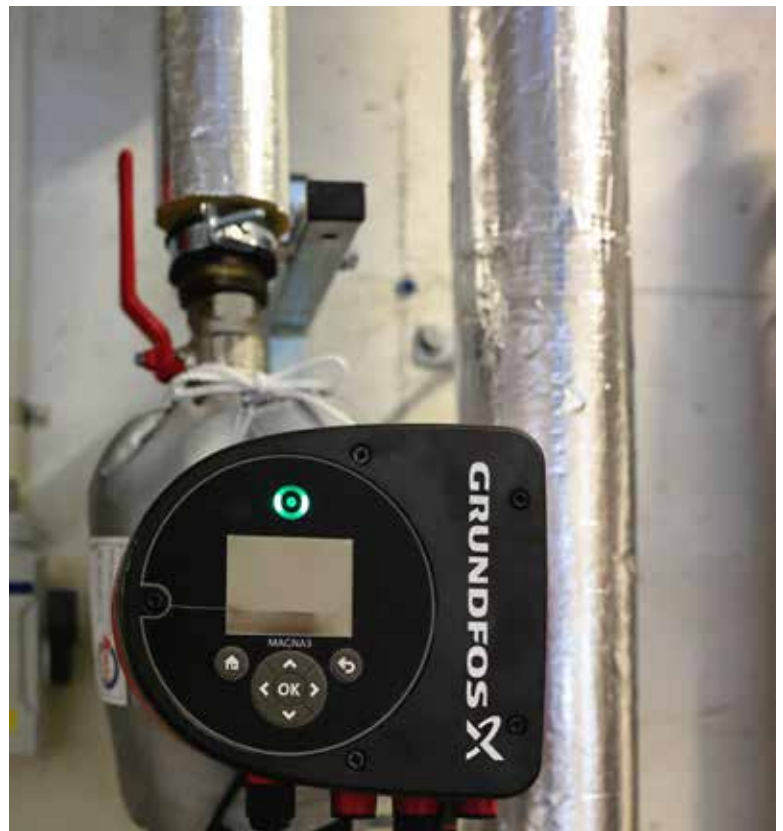
Det er ikke mange fysiske endringer å se som følge av EPC-arbeidet. Den grå isolasjonen bak målerapparatet er ett av de få tegnene på EPC man ser med det blotte øyet. Foto: Eivor Eriksen
