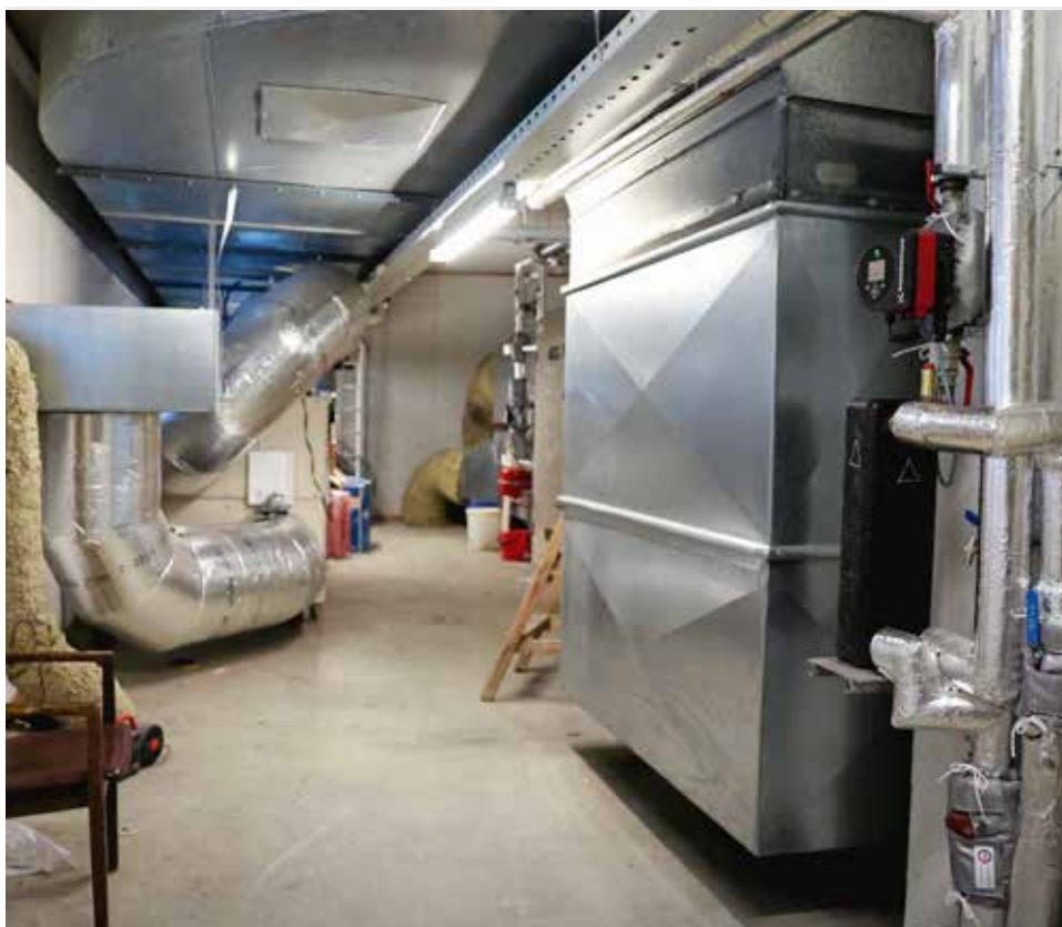
Ventilasjonsrommet i Aurskog-Høland rådhus minner trolig om tilsvarende rom i mange kommunale bygninger. EPC handler mer om styring enn store fysiske investeringer. Det er derfor ikke mange spor å se etter energieffektiviseringsarbeidet. Foto: Eivor Eriksen
