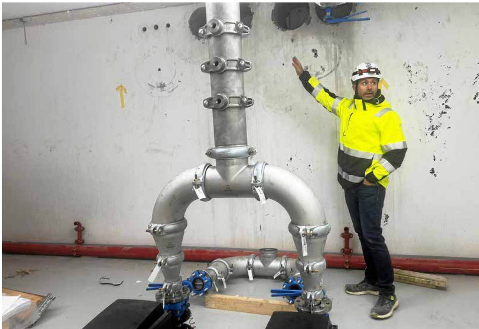
Faglig leder i Byggenergi, Frode Arnesveen, viser frem pumpene som frakter glykolen inn i det tekniske rommet i underetasjen av leilighetskomplekset.
