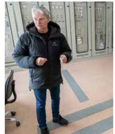
Erling Martinsen, konsernsjef i Ymber, inne på Storslett transformatorstasjon. Foto: Jørn Holm
