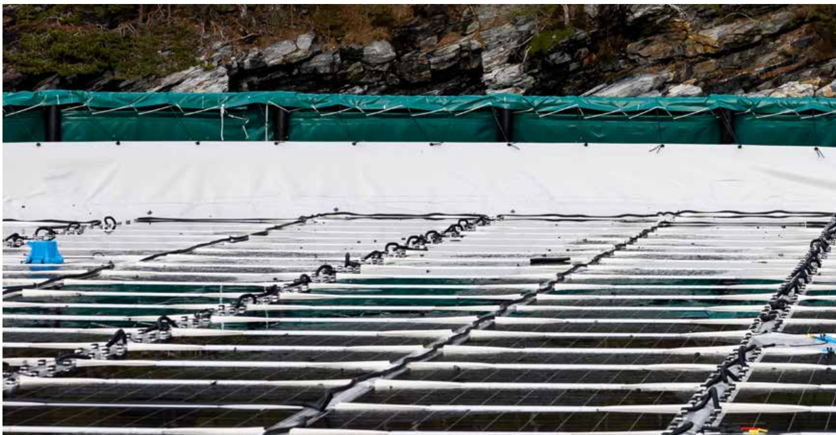
Membranen som solcellepanelene ligger på, er så sterk at prosjektleder Asgeir Bakken Rognstad i Alotta fritt kan bevege seg rundt og på panelene.
