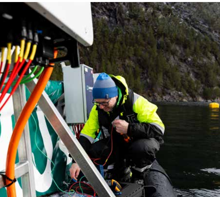
i et skap før den sendes videre til forflåten på en ledning i sjøen. Prosjektleder fungerer som det skal.
