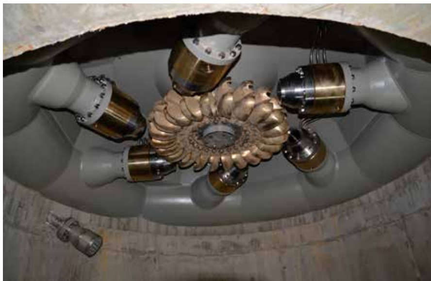
▲ Turbinhjulet til en av to turbiner på Eikemo kraftverk, sett nedenfra.
