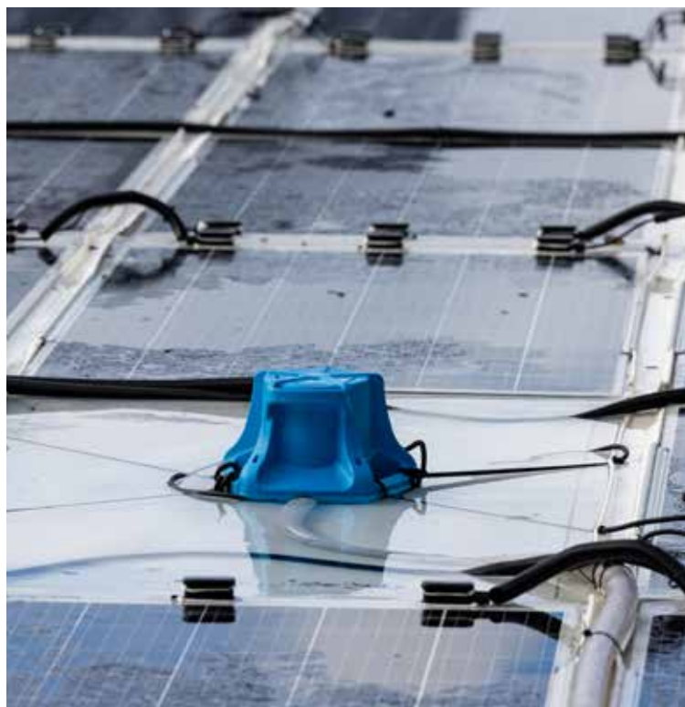
Litt regnvann oppå solcellepanelet gjør ingenting. Pumper sørger for at det aldri blir for mye vann oppå den vanntette membranen.
