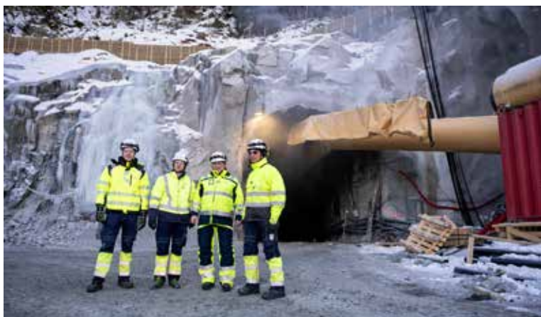
Det sprenges så røykskyen står fra det som skal blir tunnelen ned til Feios Kraftverk. Fra venstre teknisk prosjektleder Bernt Erlend Fridell, konserndirektør for produksjon Erlend Bårgard, konsernsjef Terje Bakke Nævdal og utbyggingsjef/prosjektleder Harald Fimreite. Foto: Vidar Stadheim
