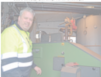
Det er selve flisfyrkjelen som gir 700 kw. varmeenergi...
