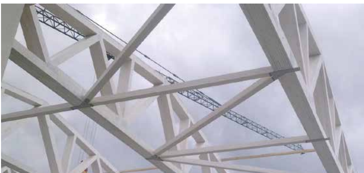
Branndimensjonerte takstoler (Foto: Pretre)
