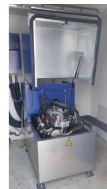
Generatoren som omdanner gass til strøm.
