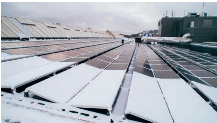
Down Town har fått verdens største solcelleanlegg med snøsmelting på taket.
